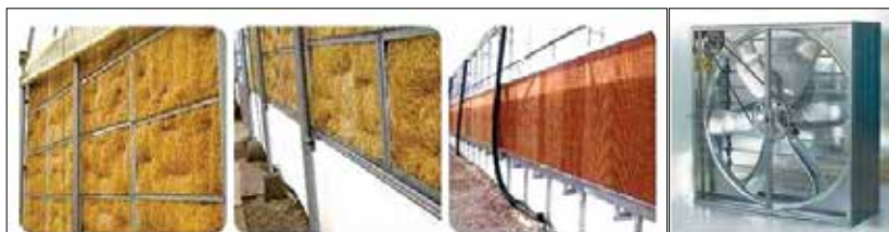
شکل ۴ - سیستم پوشال و پنکه برای تنظیم دمای داخل گلخانه
