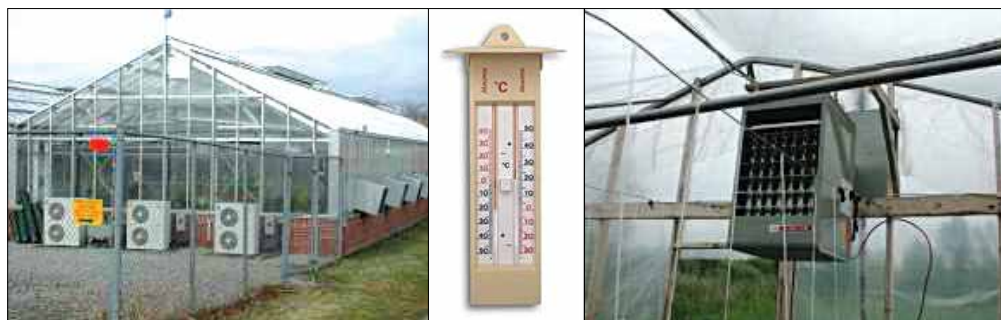
شکل ۷ - نمایش نصب سیستم بخاری و کولر گازی برای تنظیم دمای داخل گلخانه
