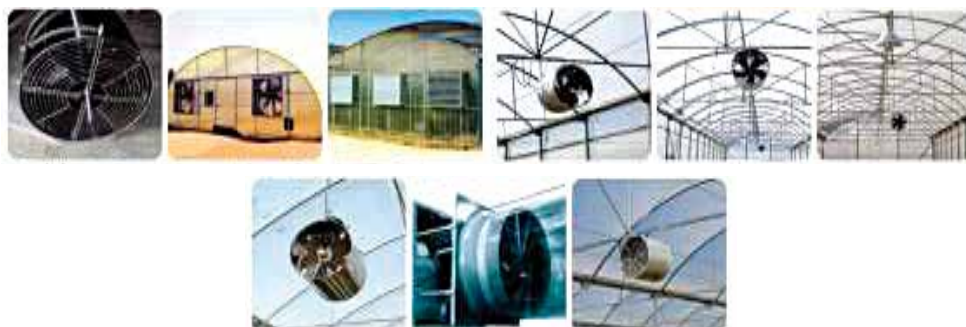
شکل ۵ - سیستم تهویه با پنکه ها یا فن های خارج کننده هوای گرم
